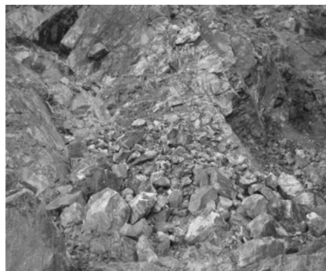
Рис. 4. Осыпь в борту карьера (месторождение «Центральное»)
