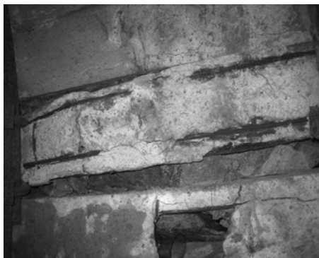
Рис. 2. Прогрессирующая коррозия железобетонных плит-стяжек
