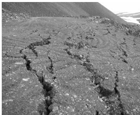
Рис. 3. Оползень в отвалах (месторождение «Центральное»)
