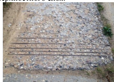
Рис. 4. Разрушение поверхностного слоя плит ПАГ
