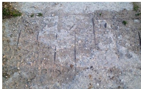
Рис. 2. Образование усадочных трещин в зоне арматуры
