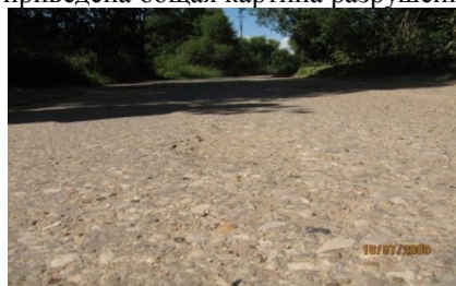
Рис. 3. Разрушение поверхностного слоя сборных ж/б плит
