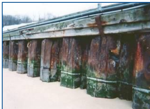
Рис. 1. Коррозия шпунтовой стенки
