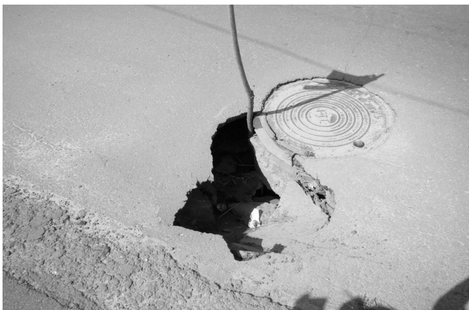
Рис. 1. Нарушение сплошности асфальтового покрытия в Новобелицком районе (фото 2014 г.)
