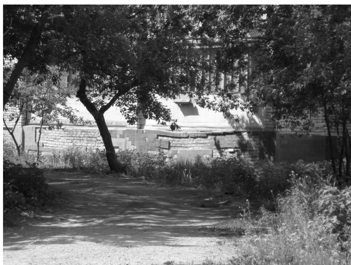
Рис. 1. Деформации основания здания в результате периодически повторяющихся просадок (Прибрежный микрорайон г. Дзержинск)
