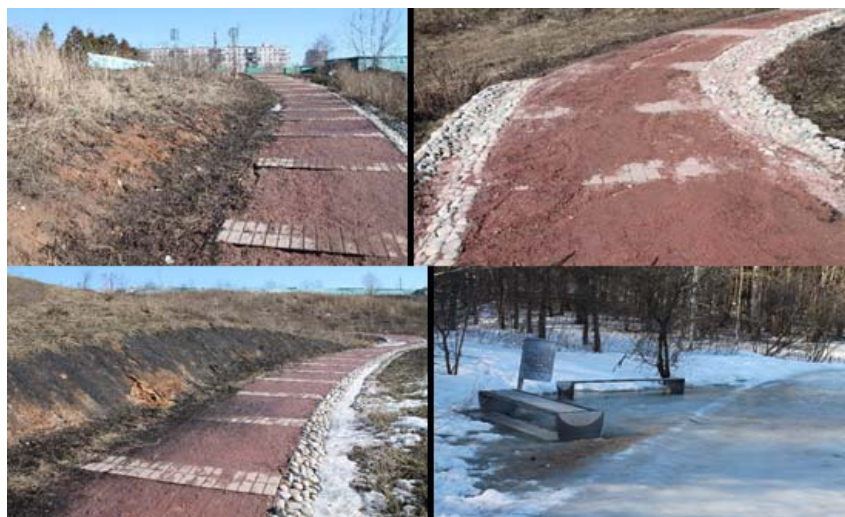
Рис.3. Неправильная организация отвода стока поверхностных вод.
