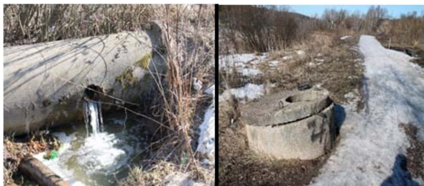
Рис.5. Ненадлежащее размещение подземных инженерных сетей
