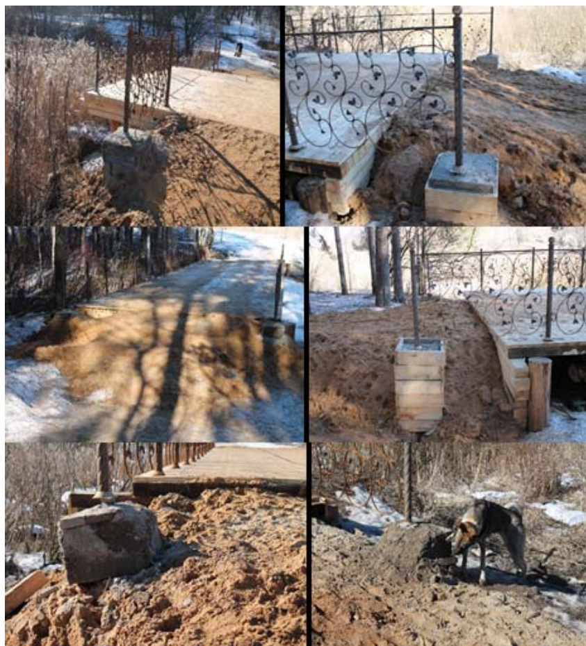
Рис.4. Несоответствующее строительство мостов и пешеходных зон.
