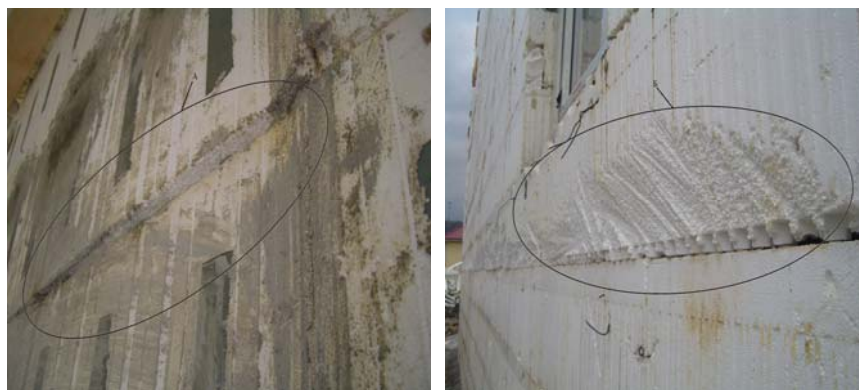
Рис. 1. Нарушение геометрических параметров наружной стены, возведенной в несъемной пенополистирольной опалубке А – выпирание опалубки; Б – "заглаживание" дефекта
