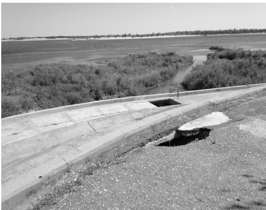
Рис. 3. Суффозионный провал в верхней части откоса. Направление выноса грунта в сторону провала плиты в нижней части склона
