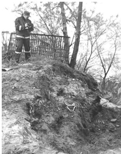
Рис. 2. Вершина оползня вблизи частного домовладения
