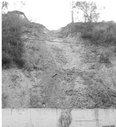
Рис. 3. Оползень на участке подрезки склона
