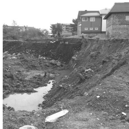
Рис. 5. Разгрузка подземных вод в стенке срыва оползня (22 сентября 2015 г.)
