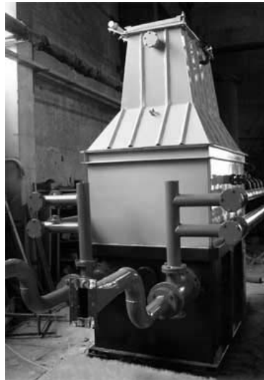
Рис. 6.2. Газогенераторный модуль для выработки генераторного газа для газодизельного генератора мощностью 200 кВт «Термотех»
